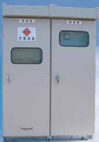
受電盤 (高圧連系盤)
