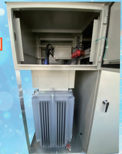
昇圧変圧器盤 内部(裏面)
