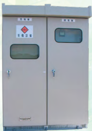
受電盤（高圧連系盤）
