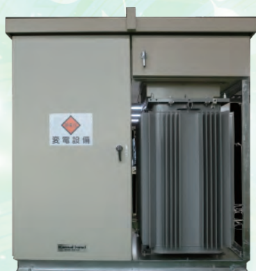
ローカル盤（通常設置）
